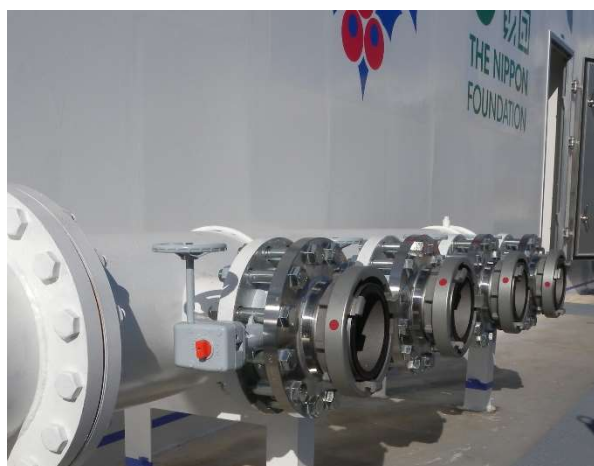
写真5 【送水用消火栓】
