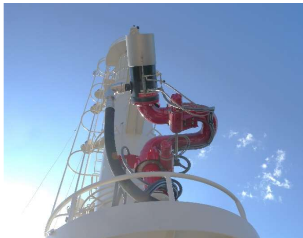
写真4 【ハイドロケム消火装置】
