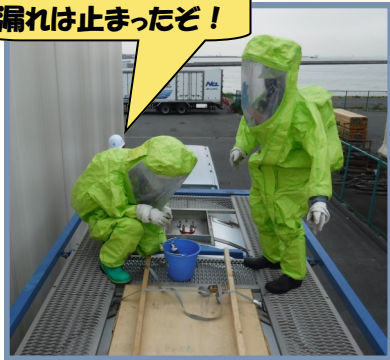
タンクの中身は移し替 えたからあとは漏れた 液体を処理するぞ！
